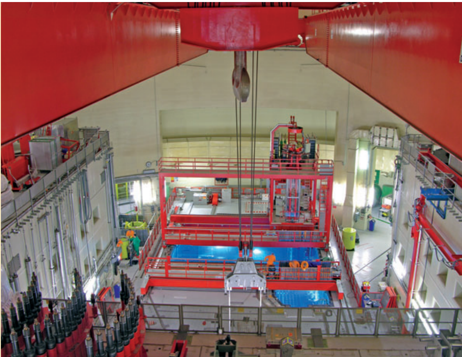
Im Vordergrund der Portalkran mit Blick auf die Brennelementlademaschine
