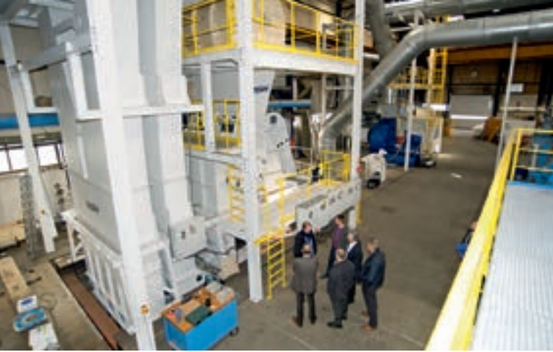
Sichter und Verrohrung im Siempelkamp-Versuchsfeld
