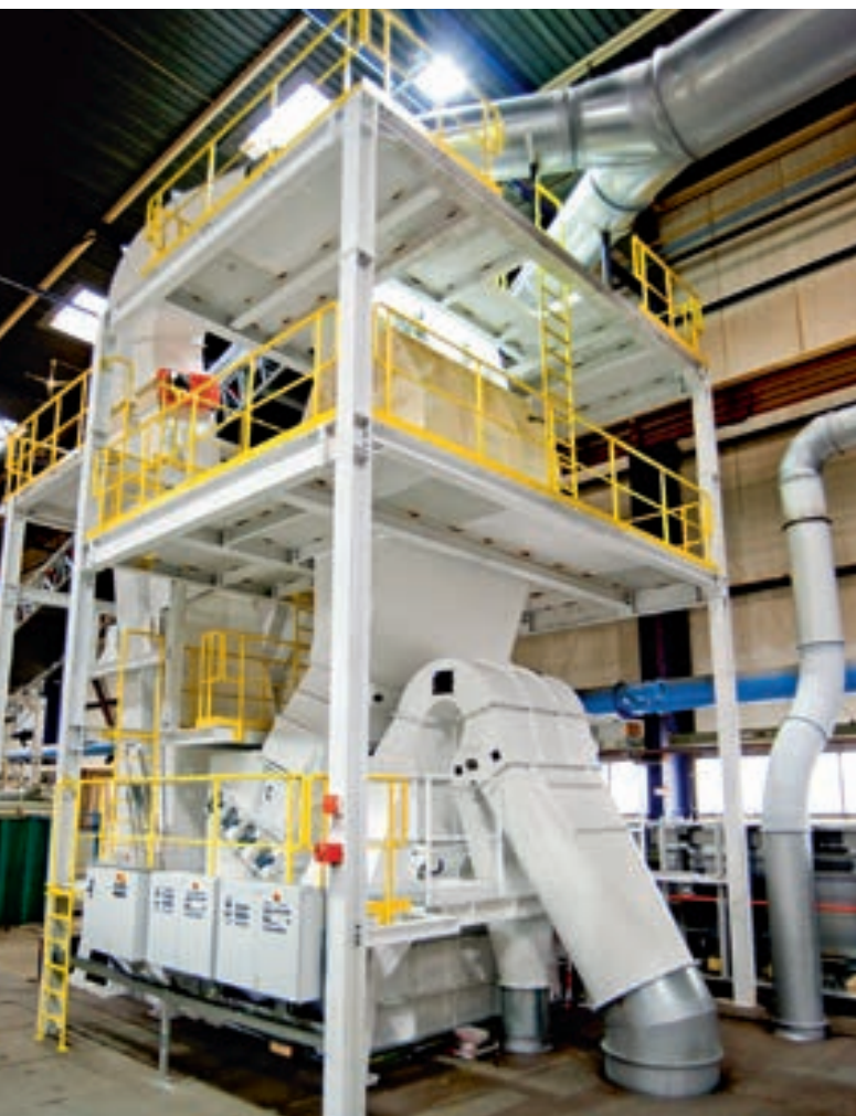
Der neue Fasersichter läuft
