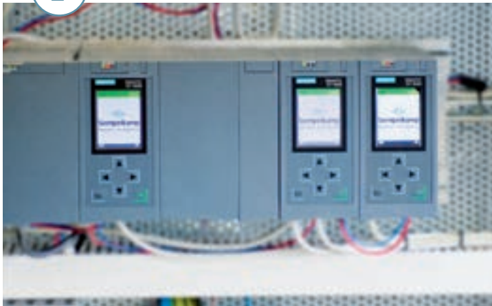
Schaltschrank mit Steuerung
