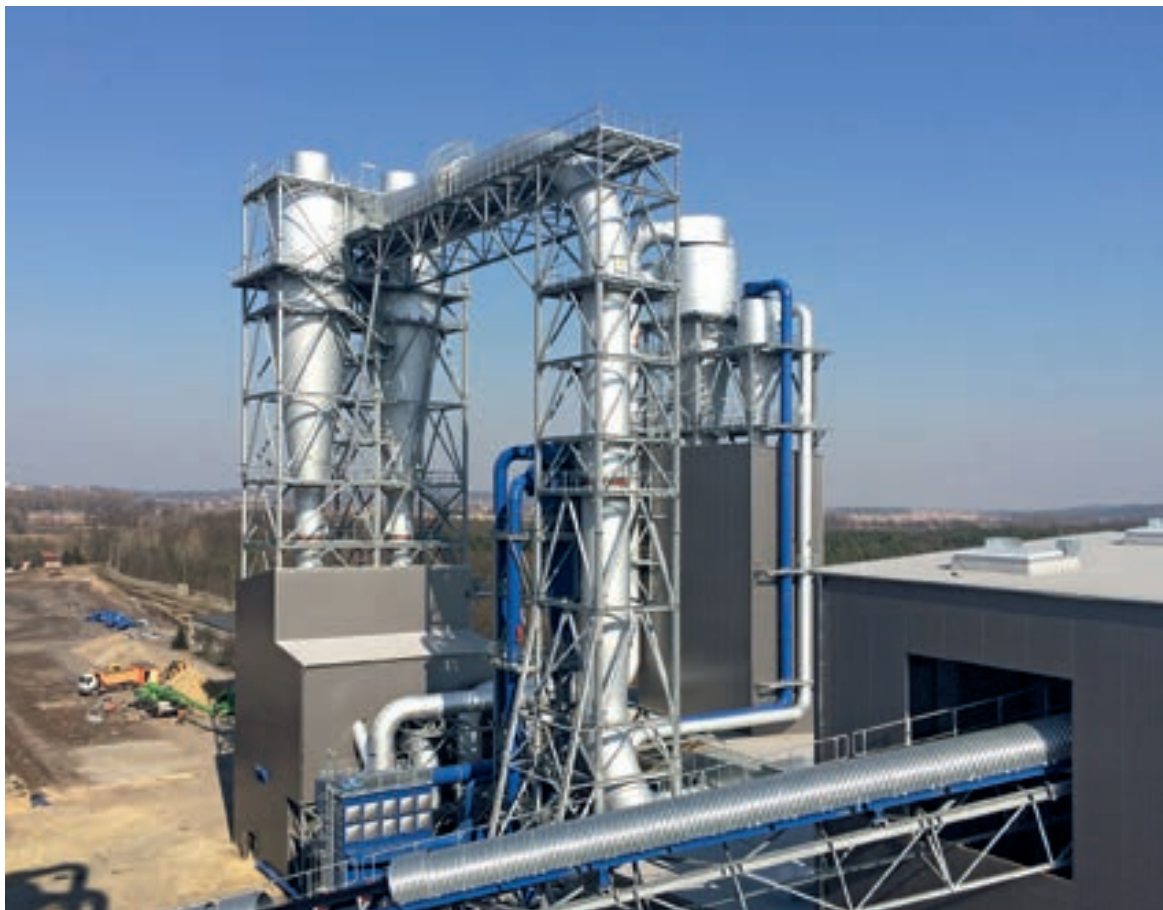
Homanit, Grosno, Polen: Büttner-Fasertrockner und Energieanlage für das neue Siempel- kamp-MDF-Werk
